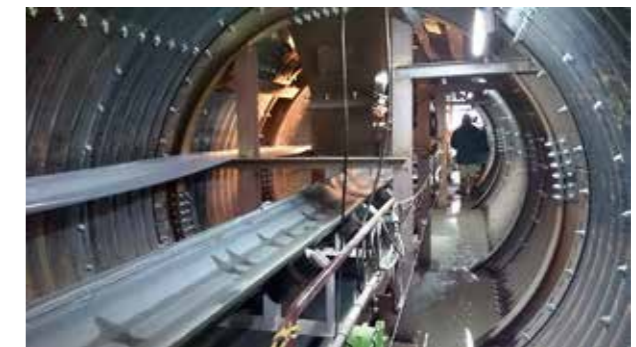
引き出しトンネル内部(設備設置後)
