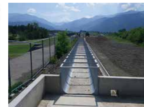
排水路での使用例
